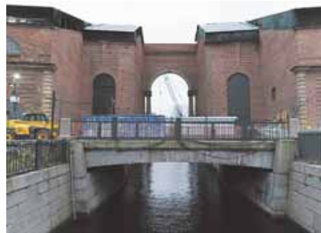
↑ Противоаварийные работы ещё идут
